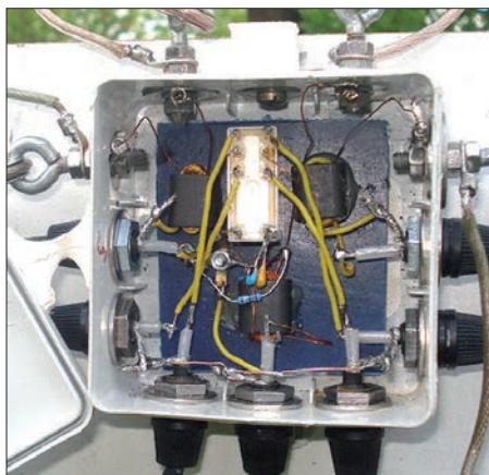
Bild 19: Zentraler Umschaltpunkt in einer IP54-Abzweigdose mit Kabelzugentlastungen Foto: DK6ED
